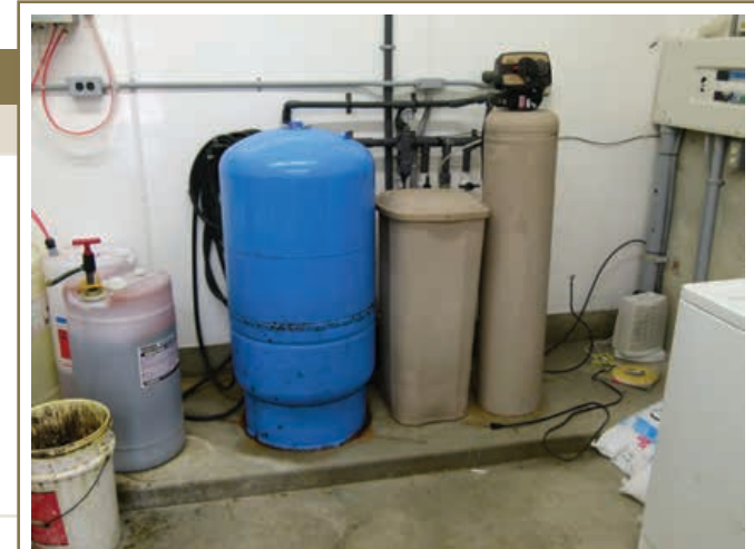
L'adoucisseur d'eau et les autres types de systèmes de traitement de l'eau doivent être inspectés et entretenus chaque année.
