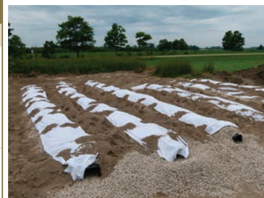
Le champ d'épuration sera clôturé pour garder les véhicules et le bétail à l'écart lorsque l'installation sera terminée.
