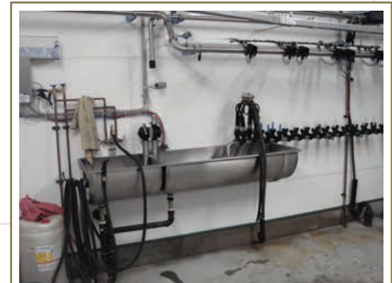
Un évier économiseur d'eau permet de réduire jusqu'à 45 % la quantité d'eau utilisée.
