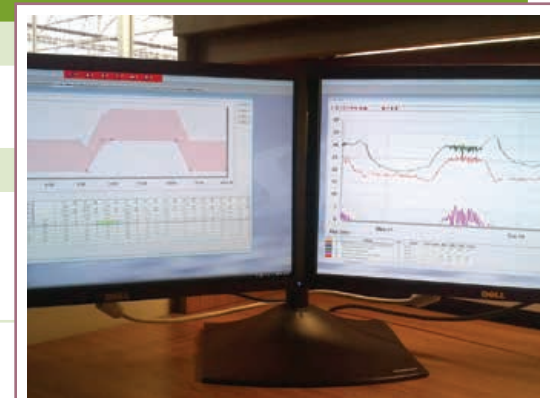
L'utilisation de commandes informatisées dans les serres peut se traduire par d'importantes économies d'énergie et de coûts.
