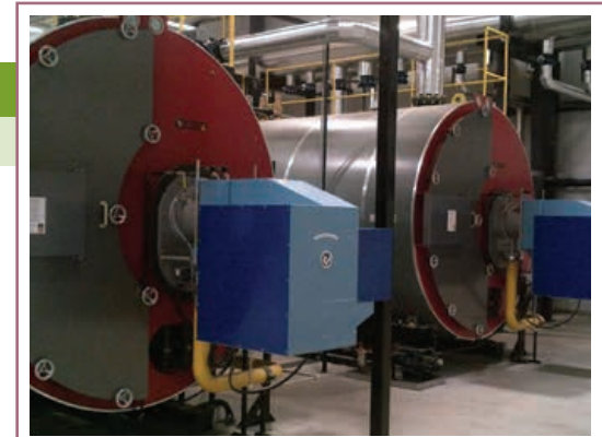
L'entretien périodique de la chaudière accroît l'efficacité du chauffage.
