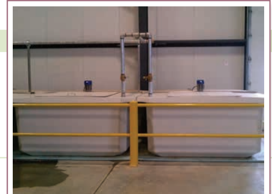
Placez les réservoirs dans un endroit isolé ou peu fréquenté, et à l'abri des chocs accidentels.
