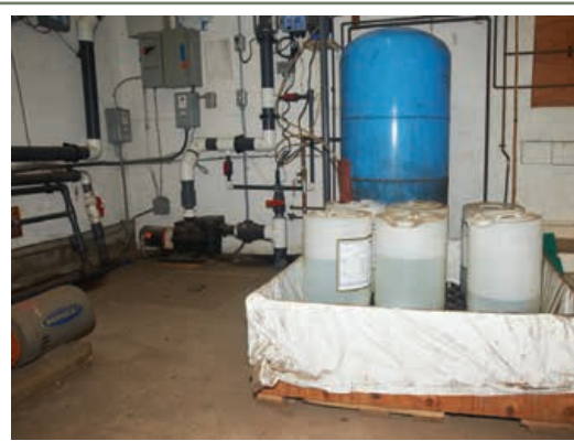
Les matières liquides exigent des précautions particulières, comme le recours à un dispositif de confinement secondaire.
