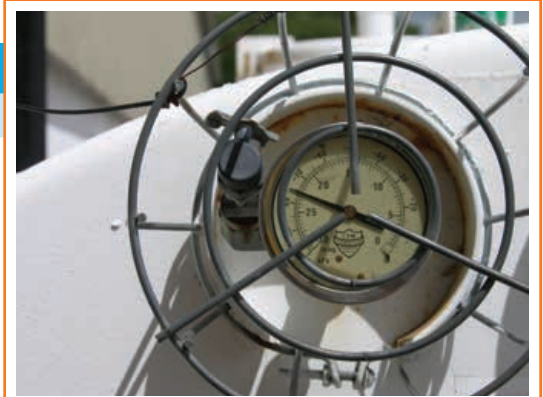
Une lecture du vide au vacuomètre indique que les deux parois d'un réservoir à double paroi sont étanches.
