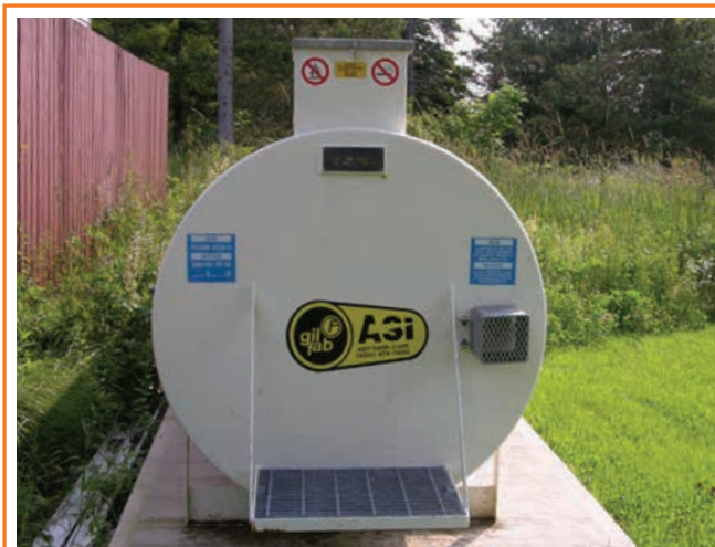
Évaluez l'état des réservoirs de stockage de combustible existants, et maintenez une protection contre la corrosion.
