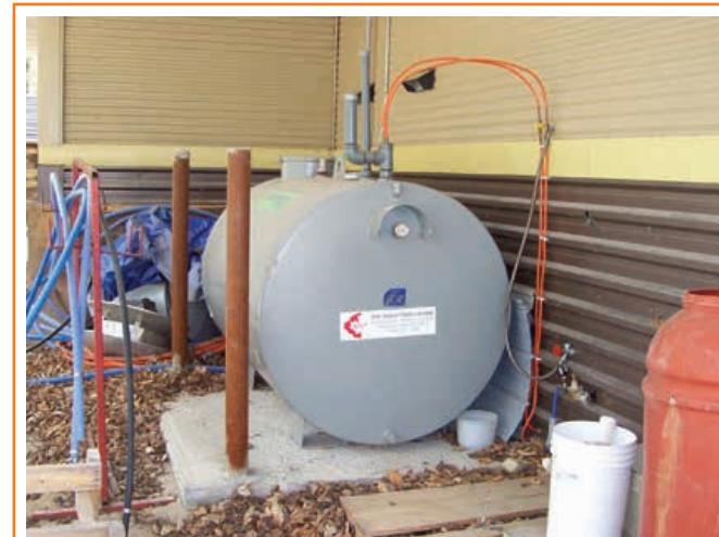
Il y a souvent des fuites au niveau des conduites.
