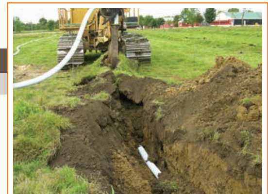
Pour réduire le risque que des contaminants pénètrent dans les drains agricoles souterrains et atteignent l'eau de surface, maintenez une distance de séparation adéquate – plus de 15 m (49 pi) – entre le conteneur d'élimination et les drains agricoles souterrains.
